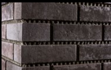
Die fertig verlegte Fläche. Nach Standzeit kann mit dem Ausfugen begonnen werden.
