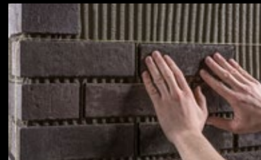
Das Setzen der Flächen-Klinkerriemchen mithilfe einer Schnur. Die Klinkerriemchen werden in das Klebett eingedrückt.
